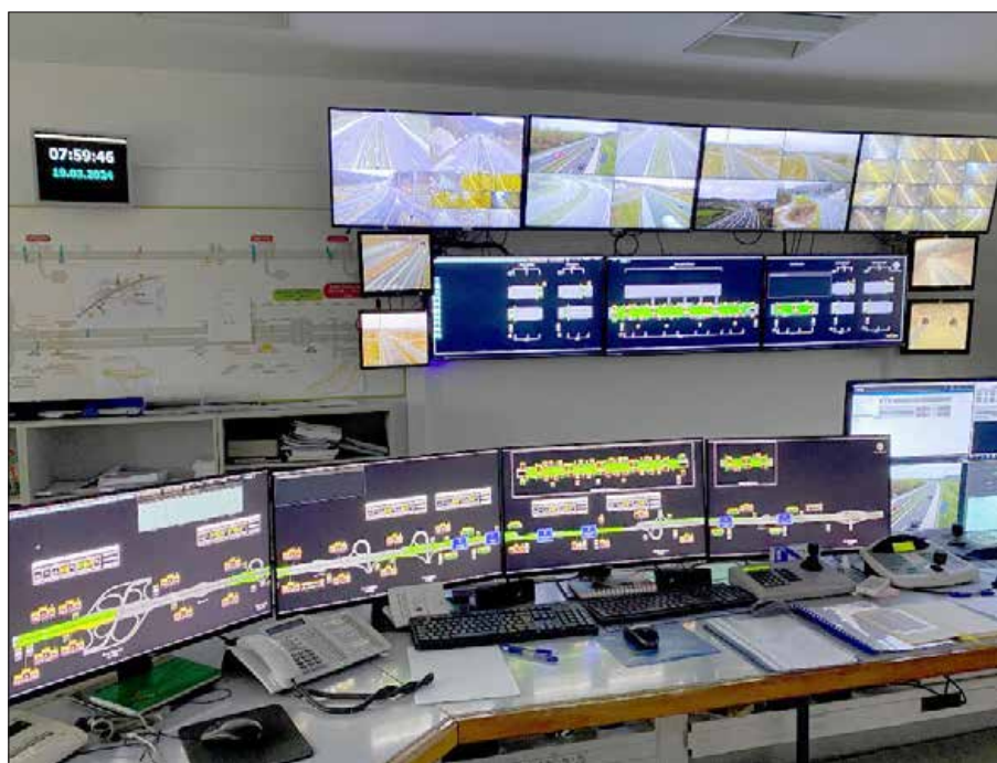
Slika 2. Izgleda kontrolne sobe u COKP Krapina
